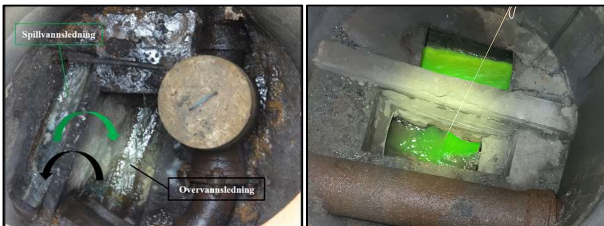
Figur 7.1.1 Felleskummer vann, spillvann og overvann: Fargeprøve (bilde til høyre) viser at utettheter mellom ledningene gjør at spillvann lekker ut i overvannsnettets i tørrvær. Grønt fargestoff er tilsatt spillvannsledning noe lengre opp, men sees i både spillvann og overvannsrenner i denne kummen. I tillegg kan avløpsvann renne over kanten mellom ledningene i kummen når ledningene har kapasitetsproblemer nedstrøms, eksempelvis ved nedbør. Foto: Johannes Viken Almås.
