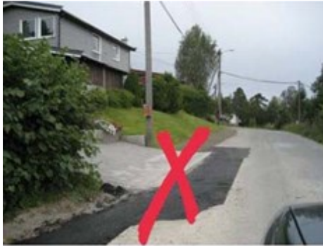
Figur 2: Uønsket endring av grøftetrasé
